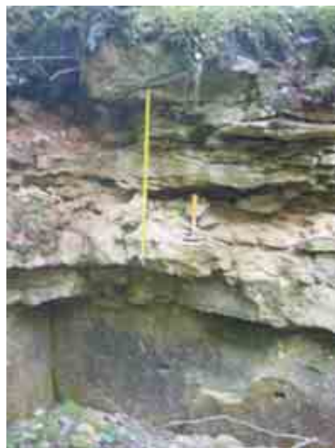
Joonis 5. Inju vana murru murenenud sein. Selge kolmikjaotus: Ülal paksukihiline lubjakivi, keskel keskmisekihiline savikas murenemisele väiksema vastupidavusega dolokivi, all massiivne ehitusdolokivi. Mõõdulint 1 m ripub ordoviitsiumi-siluri piiril
