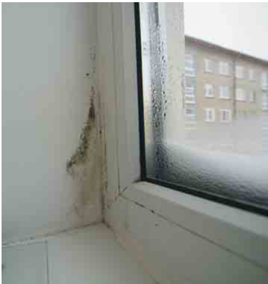
Hallitusseened aknanurgas ja akna alaossa kondenseerunud vesi
