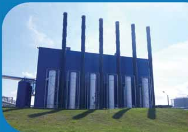
Vopak E.O.S ASi 48 MW termaalõli katlamaja
