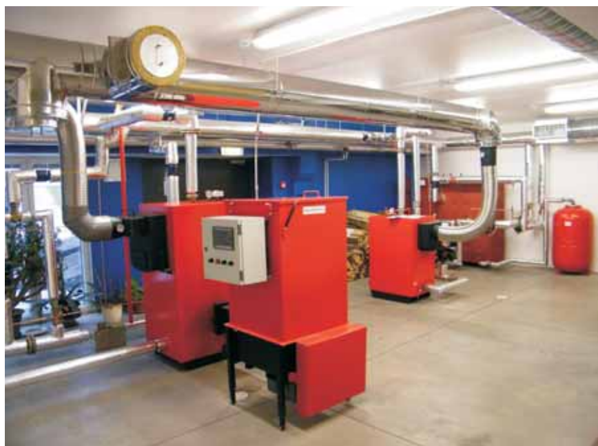
Joonis 3. EMÜ tehnikainstituudi katelseadmete õppelabor. Fotol on katlad võimsusega 50 kW ja 25 kW
