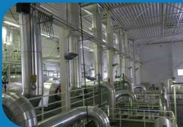
VKG Soojus ASi Ahtme 100 MW katlamaja
