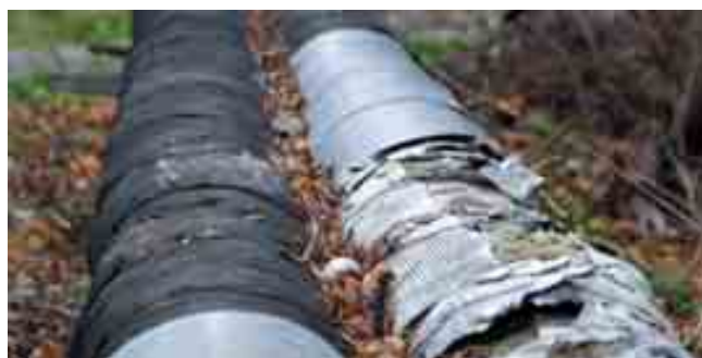
Joonis 4. Viletsas seisukorras kaugküttetorustik [3]
