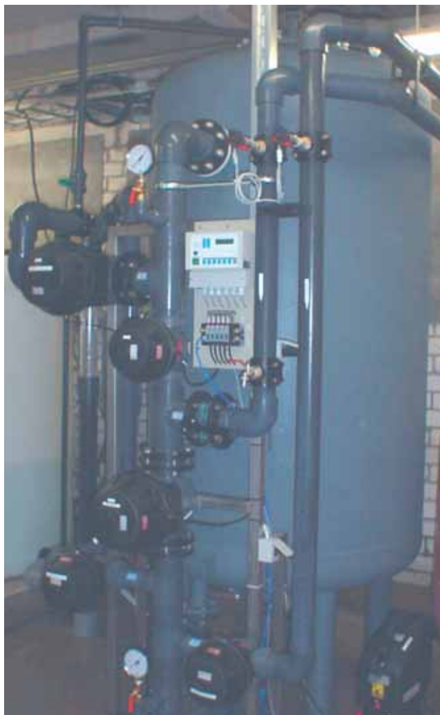
Raua- ja mangaaniärastusfilter
