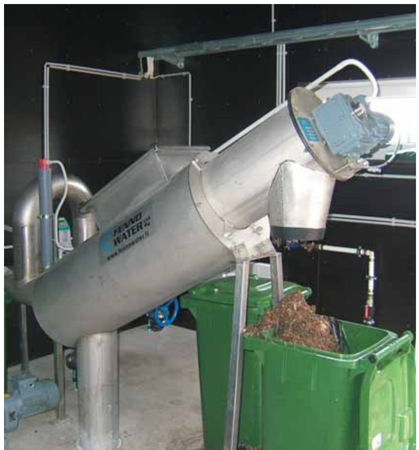
Joonis 4. Tõravere reoveepuhasti trummelsõelur
