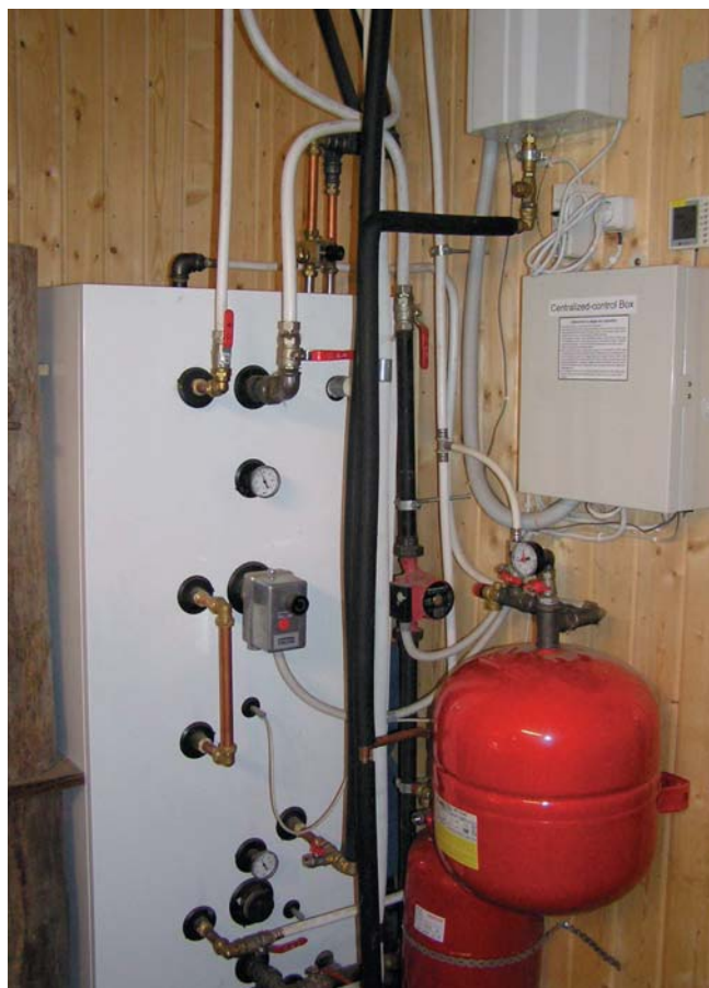
Akumulatsioonipaagiga on ühendatud õhk-vesi-soojuspump, päikesepaneelid ja 6 kW-ne elektritenn
