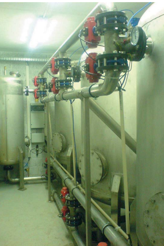
Kohtla-Järve reoveepuhasti tarbevee tööstusseadmed EURA AIR (jõudlus 48 m 3 /h)
