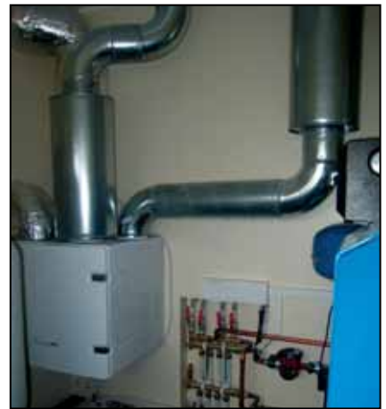
VENTILATSIOONISEADE ERAMU KATLARUUMIS
