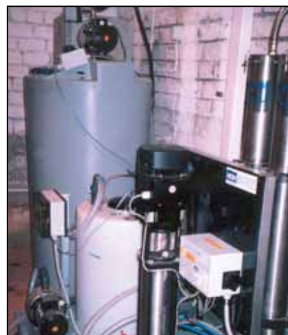
VEEPEHMENDI, PÕÖRDOSMOOSISEADME TOITEPUMP, PUHTAVEE (SEGAMIS-) MAHUTI JA PAARISSURVEFILTRI ÕHUSTUSKOMPRESSOR KÕO VEEPUHASTUSJAAMAS
