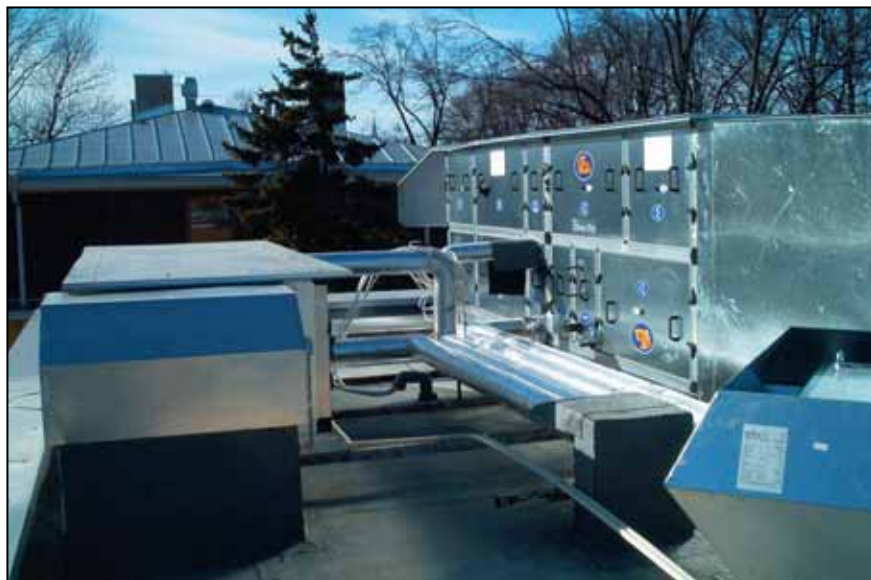
KATUSEL PAIKNEVAD VENTILATSIOONISEADMED
