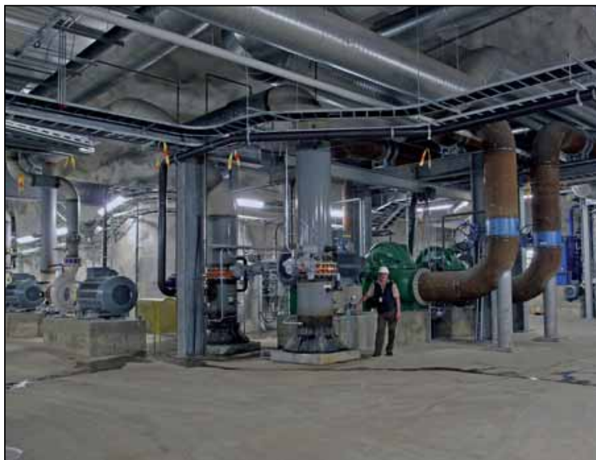
HELSINGI SOOJUSPUMBAJAAM Foto: Jorma Vilkinen, Helsingin Energia koduleheküljelt
