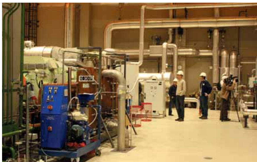
Ühekorpuseline kondensatsioon-vaheltvõtuturbiin Siemens SST600
